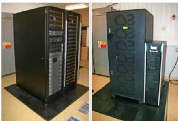
Sál centrálního datového úložiště DVISÚ
